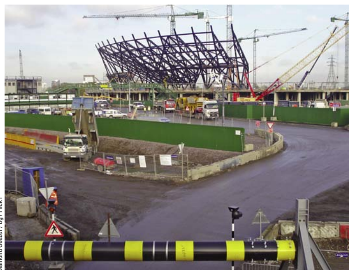
Dans le contexte actuel de récession, la réalisation de certains programmes risque d'être retardée. Tel ne sera pas le cas du principal site d'accueil des J.O. de 2012. Chantier du stade olympique en novembre 2008.
